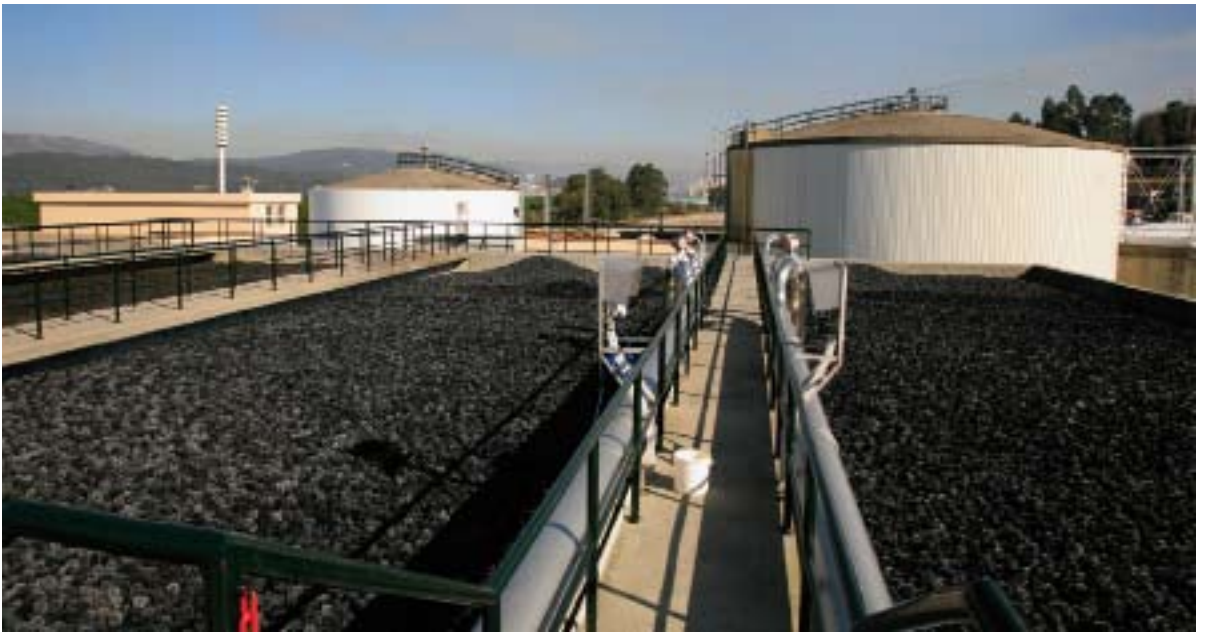
Balsas de depuración biolóxica (Depuradora dos Praceres)
