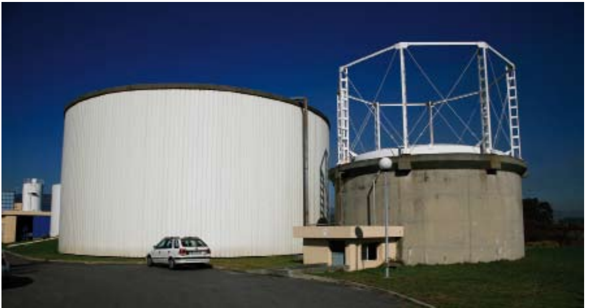
Dixestor da liña de lamas (Depurdora dos Praceres)
